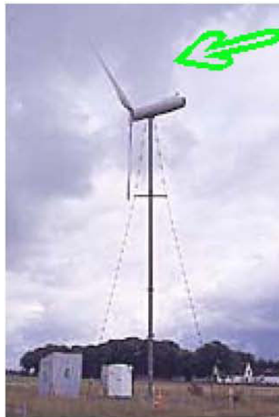
FIG. 1.9 – Petite éolienne sous le vent de 22kW avec pylône léger haubané [2].
