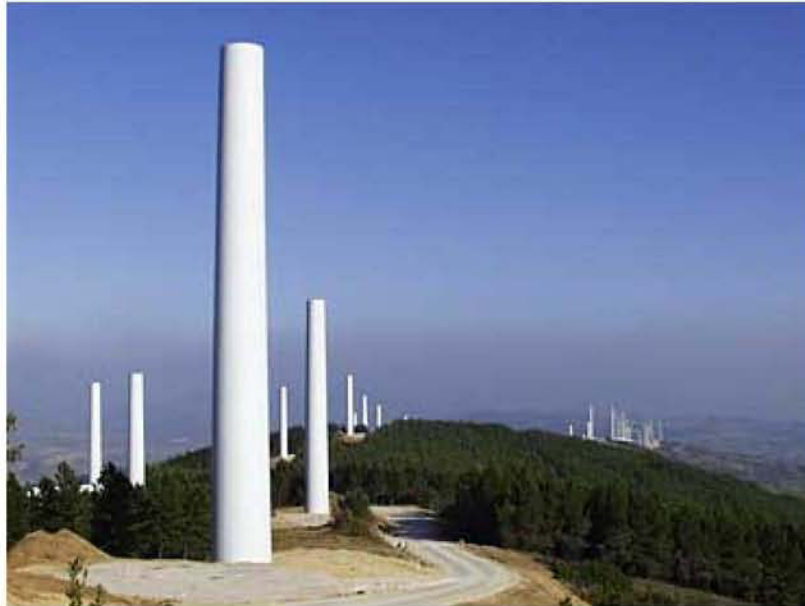
FIG. 1.7 – Pylône tubulaire d'un futur parc éolien [2].
