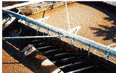
Figure I.5. Épaississement des boues par flottation
