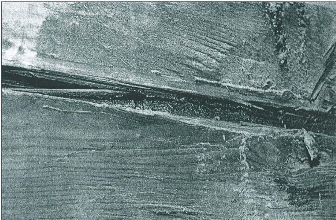
Figure 16 - Bâtiment "A". Rupture cohésive de la colle (Photo: Pizzo).
