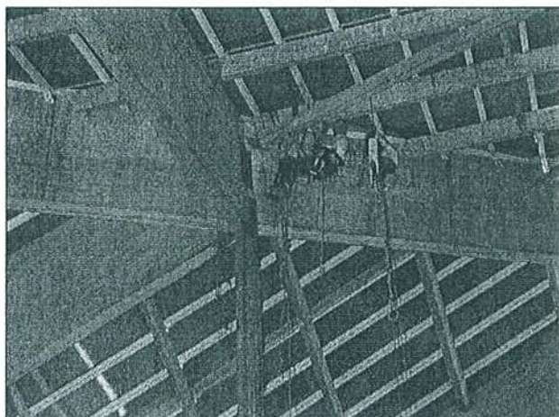
Figure 4 - Diagnostic sur poutres lamellé-collées (Aquaboulevard – Paris, Photo: Calvi).
