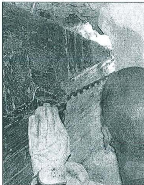
Figure 110 – Réalisation des trous dans l'entrait pour la disposition des tiges en acier.
