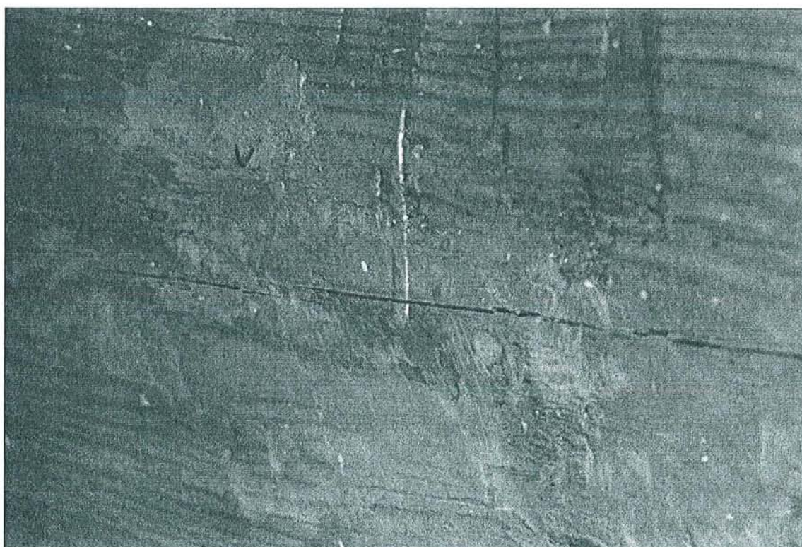
Figure 21 - Palazzo Steri. La rupture dans la résine coulée montre que le bois a varié ses dimensions après la restauration (Photo: Megna).
