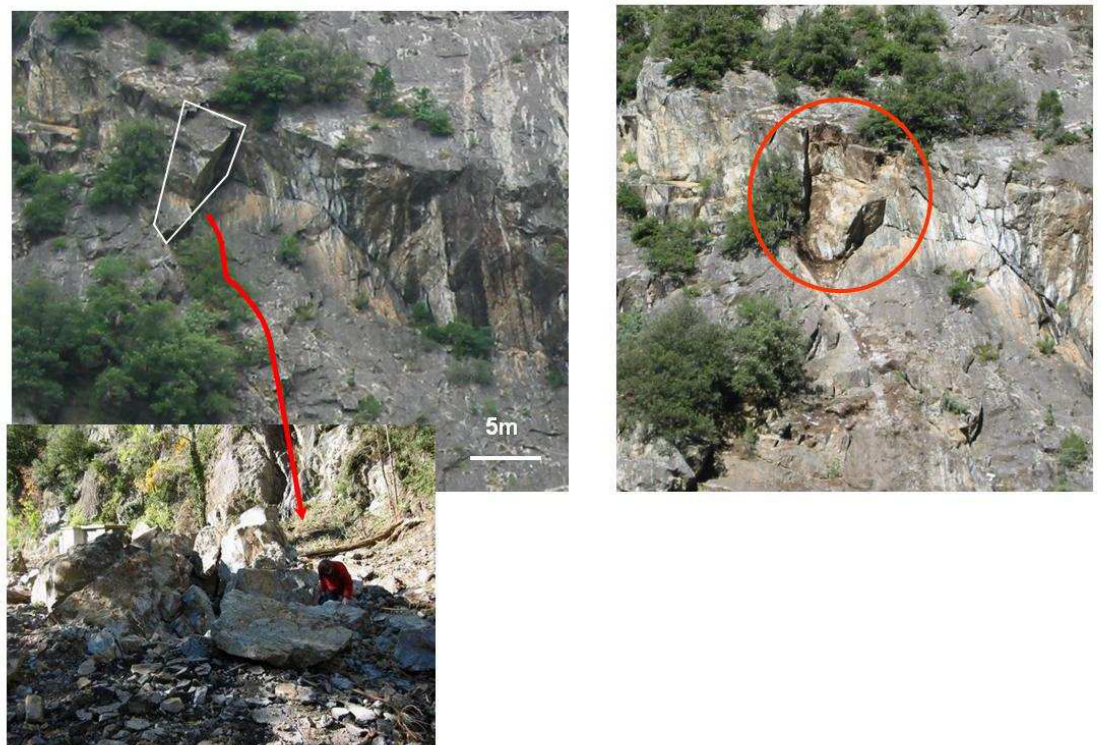
Figure 15 : Eboulement survenu en octobre 2004. En haut : Etat de la paroi avant (à gauche) et après (à droite) l'éboulement. En bas : Eboulis à hauteur des équipements hydroélectriques.
