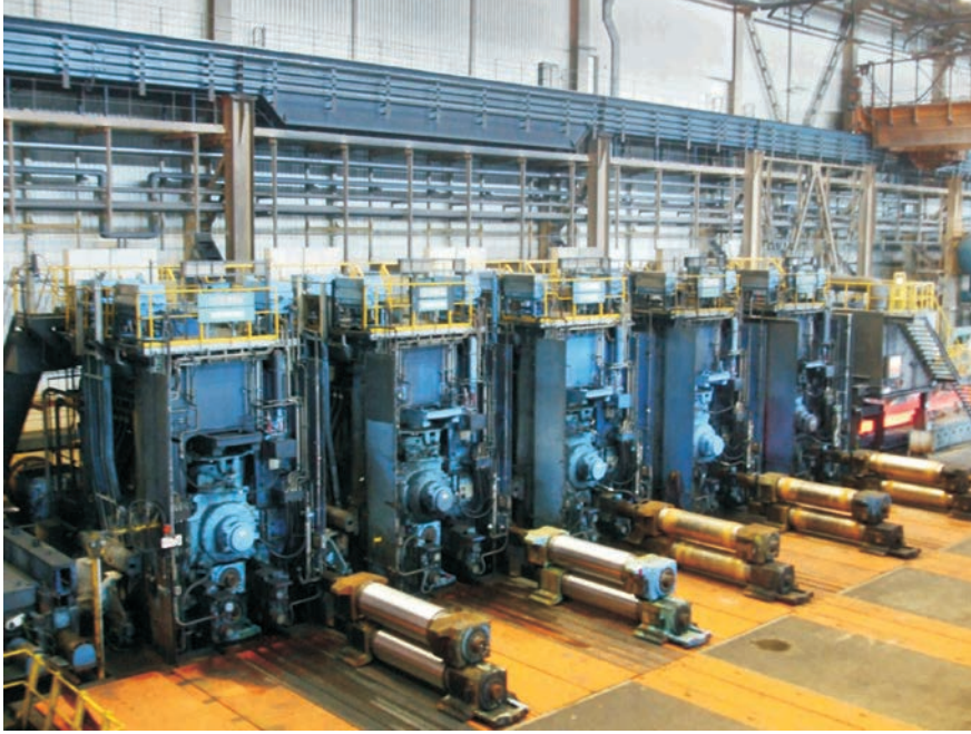
Figure 1: Laminair ArcelorMittal d'Eisenhüttenstadt
