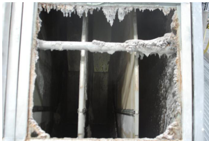
Figure 4-91. Photographie des slimes au niveau d'un filtre à disque
