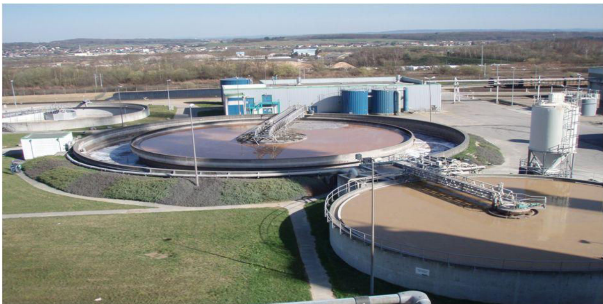
Figure 5-117. Photographie du traitement primaire
