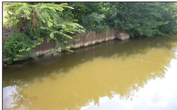
Photos n°34: Exemple d'une berge bétonnée au niveau de Nomeny (partie médiane)
