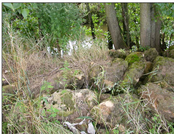
Photo n°26: Enrochements perchés par rapport au cours d'eau, qui témoignent d'une ancienne protection
