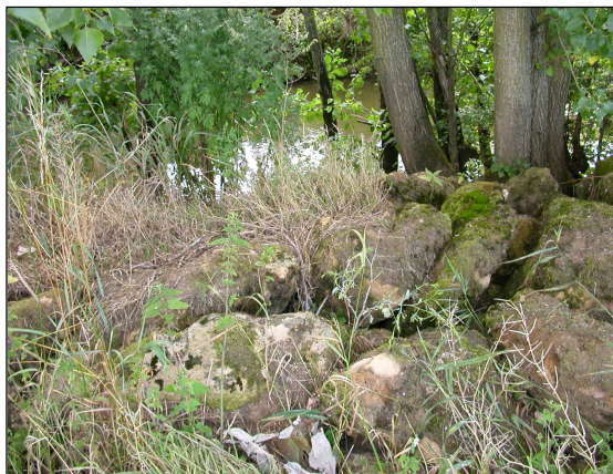
Photo n°26: Enrochements perchés par rapport au cours d'eau, qui témoignent d'une ancienne protection
