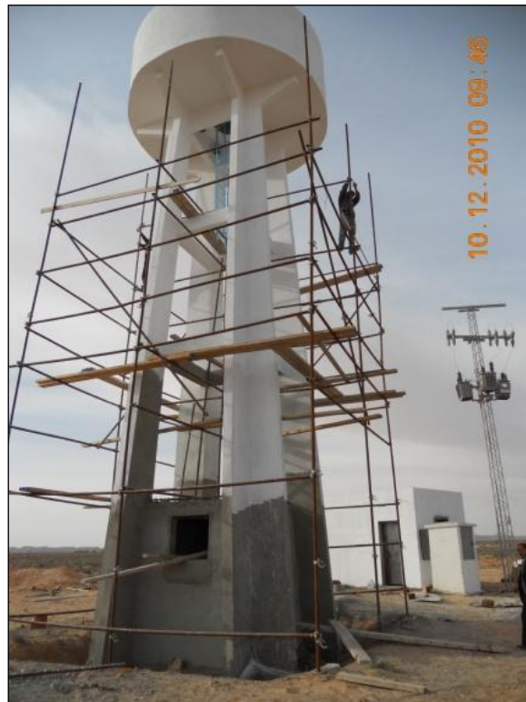
Photo 1. Construction d'un réservoir d'irrigation dans l' imada de Menzel Habib en 2010 (Mzioudet, 10/12/2010)
