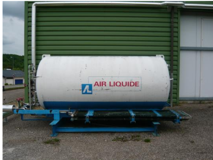
Figure I-6 : Réservoir de stockage de l'azote à basse pression (BP)
