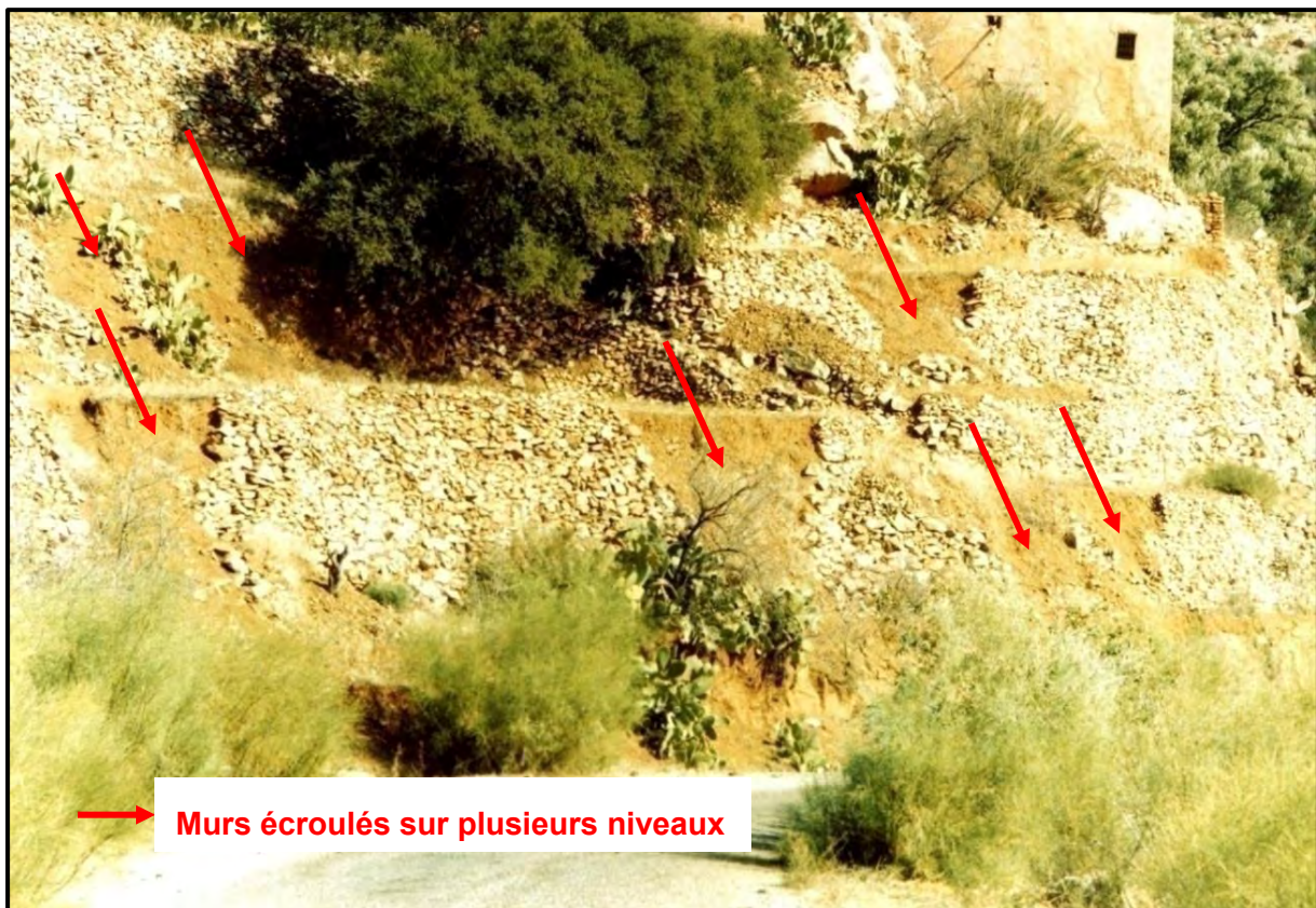
Cliché 91. Murets de soutènement effondrés et parcelles encore bien en place. Douar Aït Ihya, commune rurale de Tanalt. Cliché : M. Ziyadi, mai 2005
