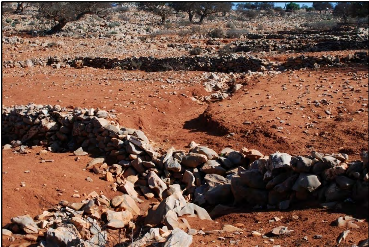
Cliché 94. Échancrure au milieu d'un mur de soutènement amenant au ravinement des parcelles cultivables sur plusieurs étages. Plateau des Akhsass. Cliché : M. Ziyadi, 2008.
