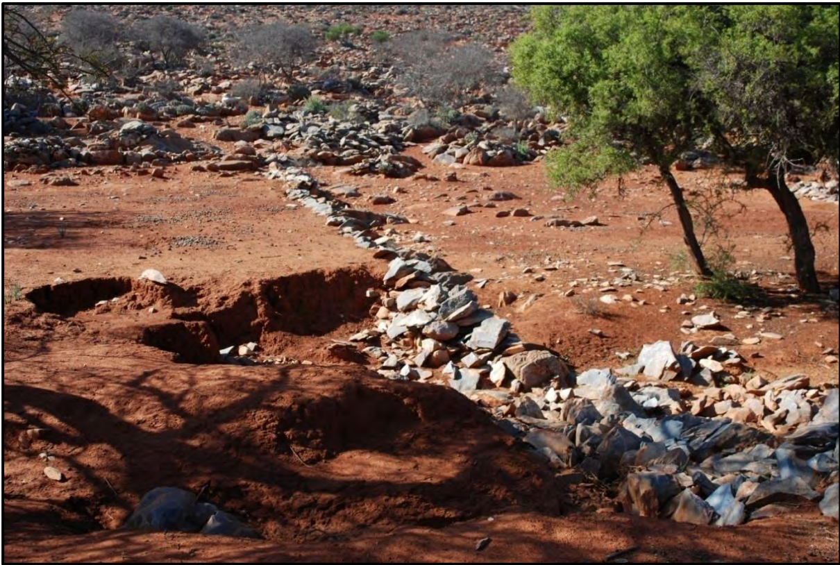
Cliché 95. Type de dégradation qui affecte les terrasses de vallons. Plateau des Akhsass. Cliché : A. Humbert, novembre 2008.
