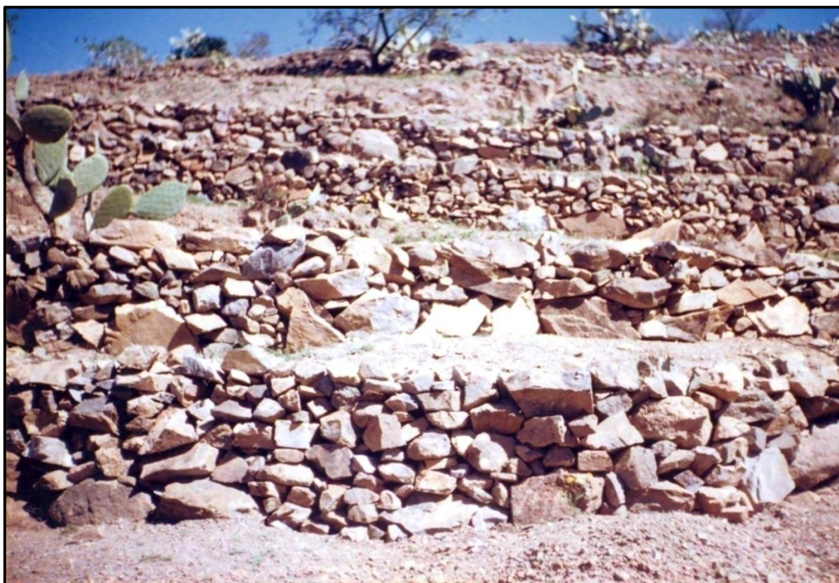
Cliché 89. Premier stade de dégradation d'une terrasse abandonnée. Douar Takoucht, commune rurale de Tanalt. Cliché : M. Ziyadi, mars 2003.
