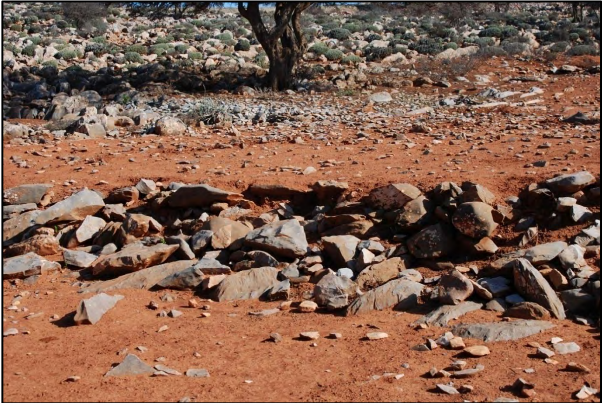
Cliché 96. Vue d'un éroulement total d'un muret de soutènement édifié dans un vallon aménagé. Plateau des Akhsass. Cliché : M. ziyadi, novembre 2008.
