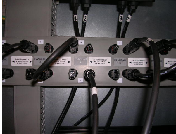
FIGURE 5.35 – Photo d’une partie du bornier de raccordement individuel du champ de panneaux Ouest.
