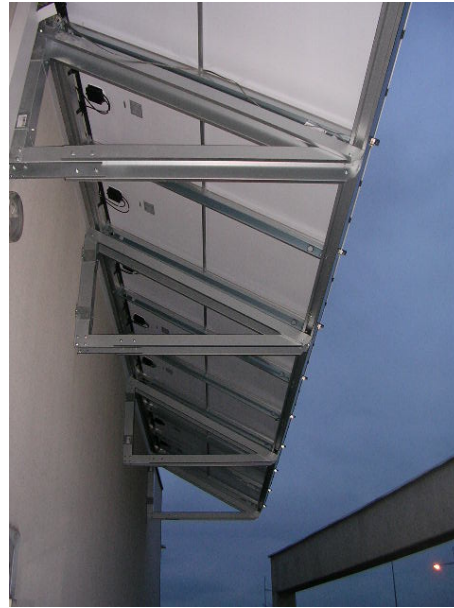
(b) Photo du champ de panneaux. Les panneaux du fond constituent la tranche Est. Les panneaux au premier plan constituent la tranche Ouest.
