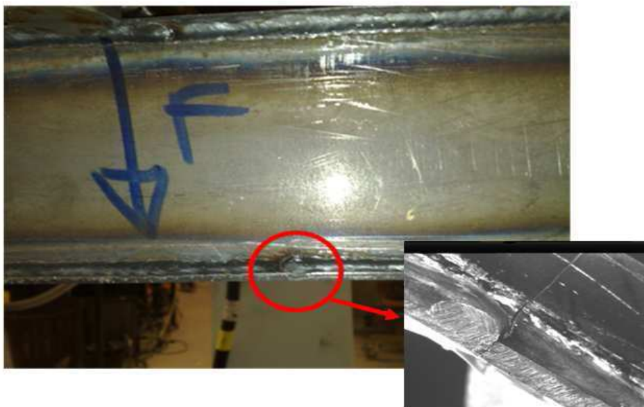
Figure 85 : Défaut à la surface de cordon de la soudure
