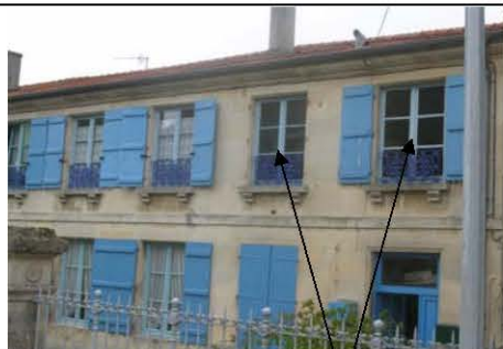
Menuiseries simple vitrage peu perméables
