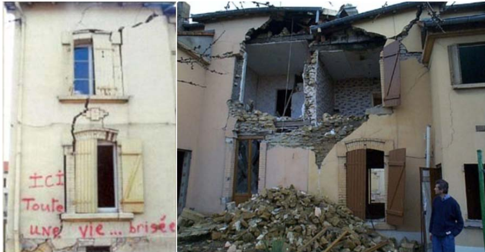
FIGURE 1.4 – Exemple de dégâts sur le bâti observés dans le Bassin ferrifère Lorrain Sud, après l'occurrence d'un effondrement minier dans les années 90.
