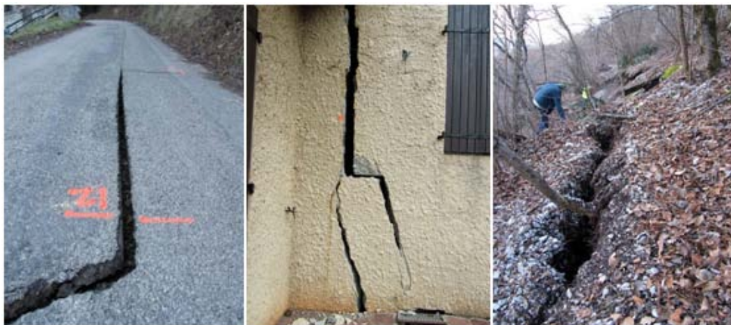
FIGURE 1.8 – Effondrement de la mine de Vicat à Saint Martin le Vinoux le 9 Janvier 2011 à 23 :07 (TU). Exemple de désordres observés en surface (source OMIV).
