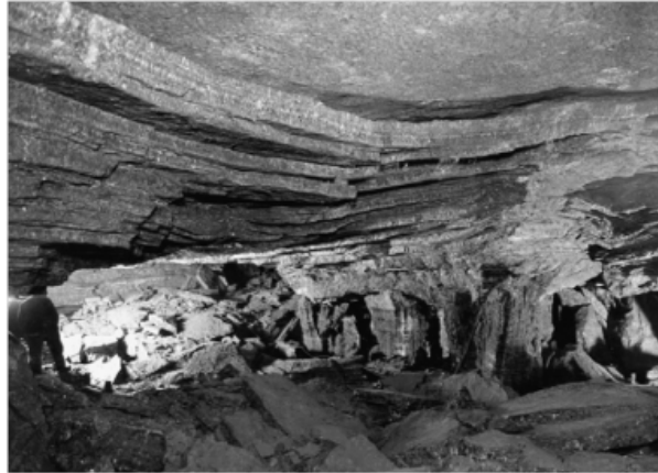
FIGURE 1.7 – Toit et pilier situé à proximité de la zone effondrée [22].
