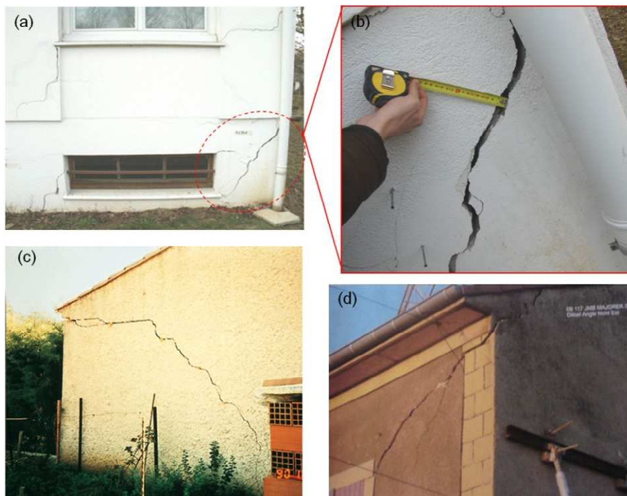
Figure I.32. Exemples de désordre provoqué par le retrait-gonflement, fissuration sur l'angle du mur (a) et (b) en bas, (c) www.qualiteconstruction.com ) et (d) en haut
