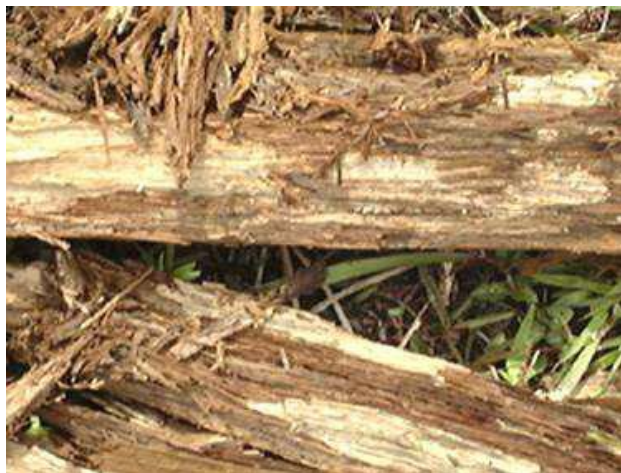
Figure 15 : Bois en contact avec le sol développant des pourritures molles
