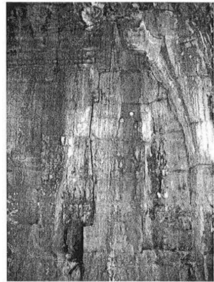
Ph. 151 : Exemple intérieur de raccord entre une tour du deuxième étage et sa galerie
