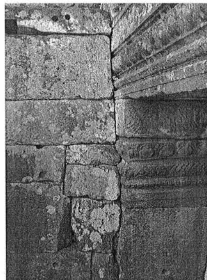
Ph. 162 : Connexion entre le mur d'échiffre de l'escalier Sud du soubassement du troisième étage et le porche Nord de la tour BY.26
