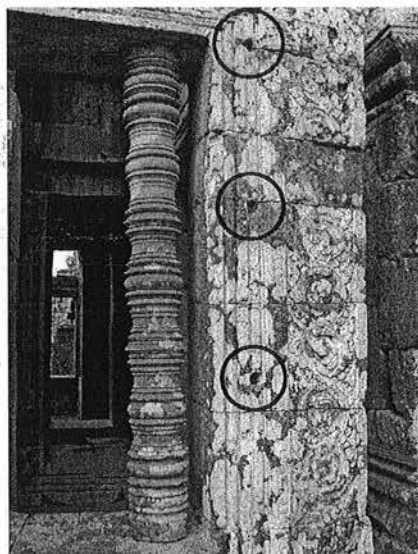
Ph. 23 : Exemple de traces d'un système d'obturation de fenêtre au troisième étage du Bayon
