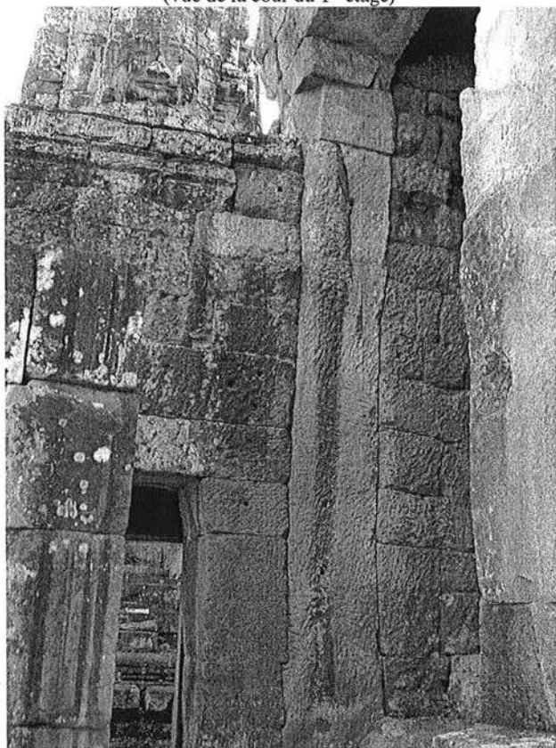
Ph. 179 : Connexion entre la galerie BY.31-32 (en rouge) et l'avant-corps Sud de la tour BY.31 (vue de la cour du 1 er étage)
