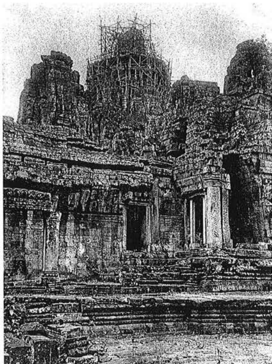
Ph. 38 : Échafaudage de la tour centrale durant sa restauration par G. Trouvé (CA)
