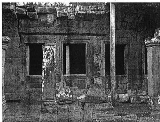
Ph. 221 : Adjonctions d'allèges à la galerie BY.32-33 (vue de la courette de l'angle Nord-Ouest du 2 ème étage)
