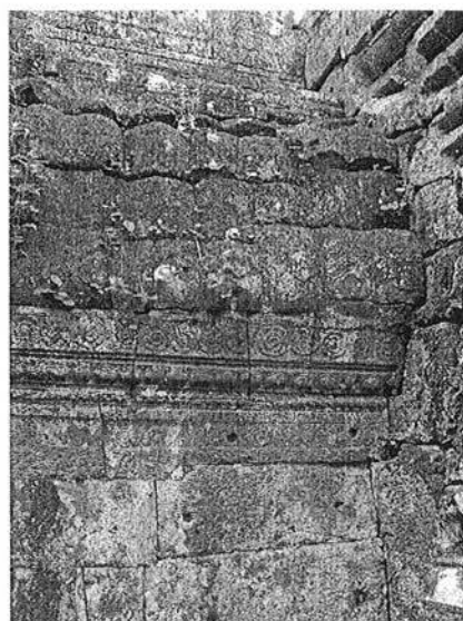
Ph. 186 : Extrados du bas-côté Nord de l'avant-corps occidental de la tour BY.22
