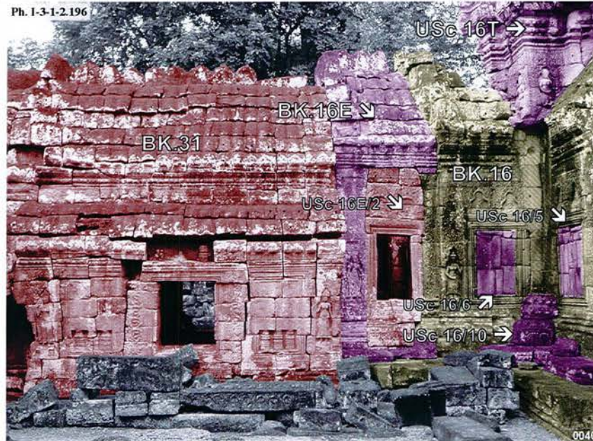
Banteay Kdei, liaison entre la salle de passage BK.31 et le porche 16E du bras Est de la tour d'angle Sud -Est BK.16 de la première enceinte : USc 16/5, USc 16/6, USc 16/10, USc 16E/2 et 16T
