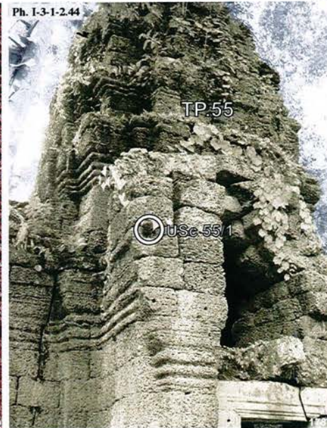
Ta Prohm, face Est de la tour TP.55 : USc 55/1
