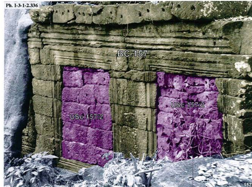
Banteay Chmar, fenêtres du bas-côté Sud du bras Ouest du pavillon Nord BC.157 de la troisième enceinte : USc 157/2
