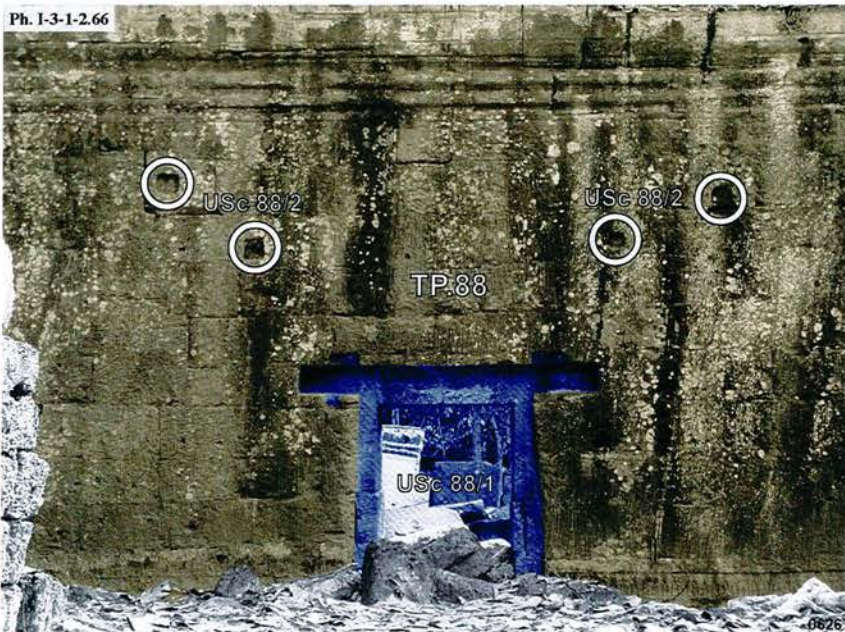
Ta Prohm, porte de la galerie TP.88 de la troisième enceinte, face Nord : USc 88/1 et USc 88/2
