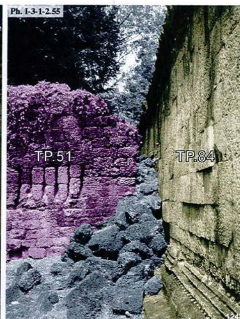
Ta Prohm, édifice TP.51 et galerie Est TP.84 de la troisième enceinte, face Sud
