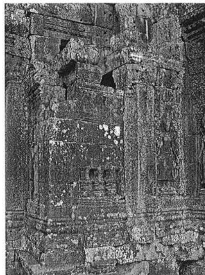
Ph. 198 : Blocage (en rouge) de la loggia Nord-Est de la tour BY.15
