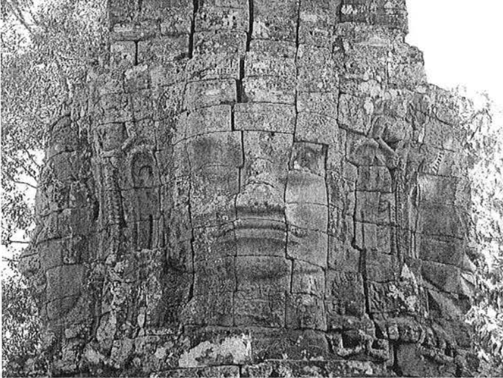
Ph. 91 : Face Nord de la porte Est de l'enceinte de domaine de Banteay Kdei
