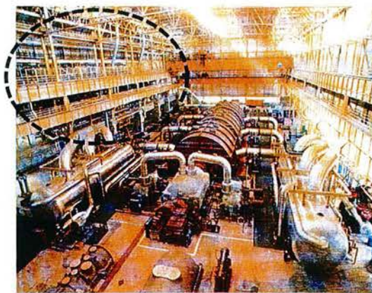
Figure 4.1 – Aperçu d'une salle des machines de centrale nucléaire et zone de maintenance difficile
