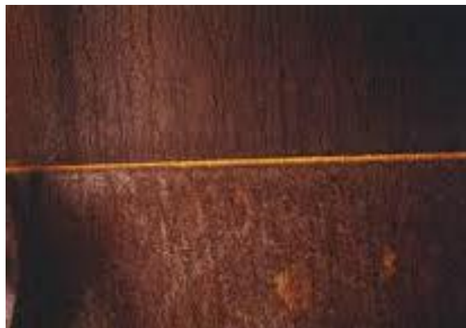
Figure 19 : Image d'une corrosion uniforme.
