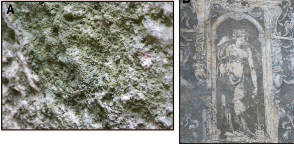
Figure 1.5 : Altération de surfaces minérales visibles à l'œil nu.
