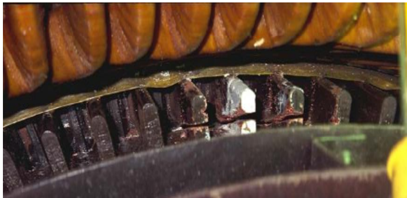
Fig. I-5: Rupture de barres sur un rotor à cage extrait de [ToI02]
