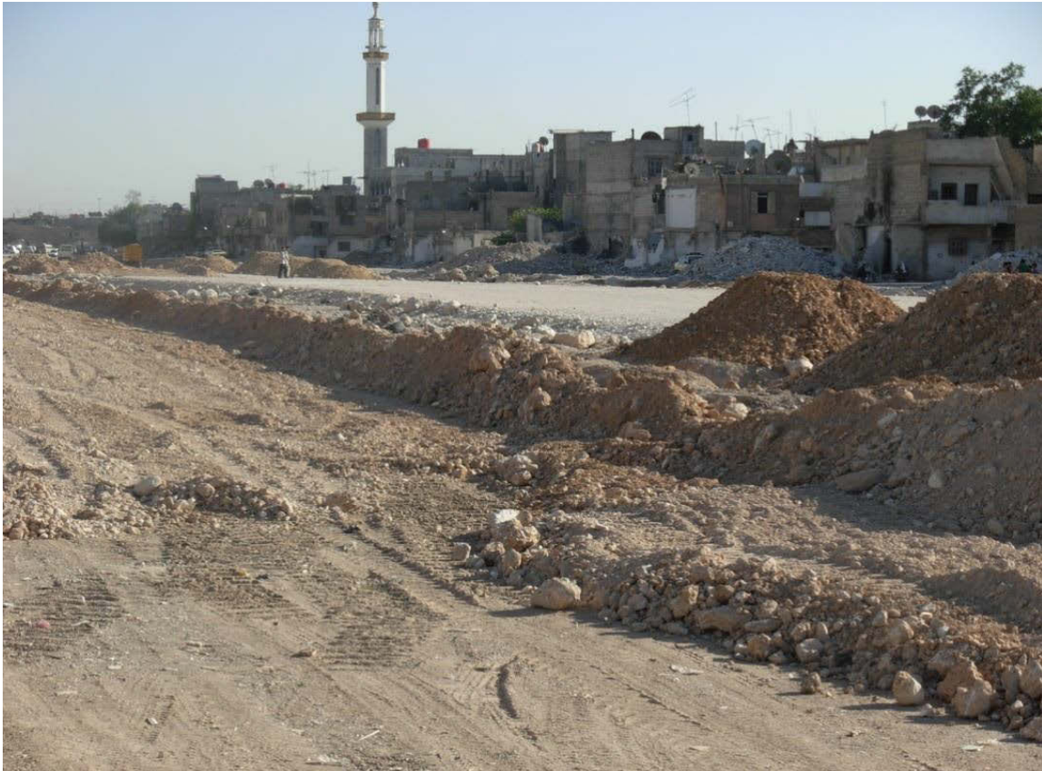
Cliché 34 : Zone d'habitat non réglementaire de Dweila'a. L'État a démoli des centaines de maisons pour construire la Rocade Est de la ville de Damas. Cliché : Main KAFA, avril 2008
