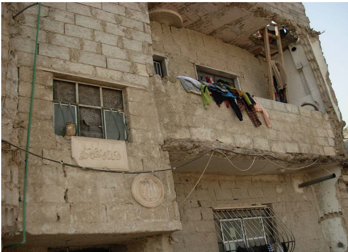
Cliché 47 : Destruction d'une partie d'une maison du quartier Dweila'a en raison de la construction de la rocade est de Damas. Ce qui reste peut toujours servir d'abri. La pièce à moitié détruite a été transformée en balcon. Cliché : Main KAFA, Mars 2010.
