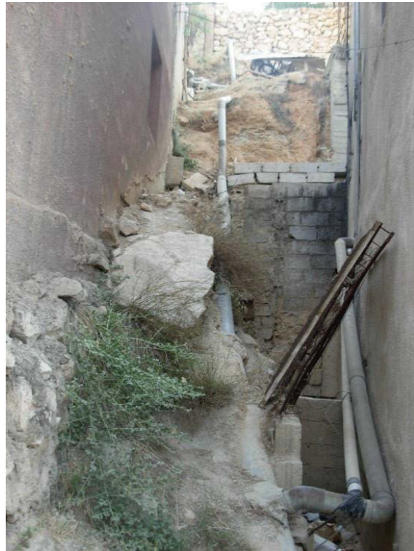
Cliché 16 : Évacuation des eaux usées à Uch Alwarwar. Les égouts sont à l'extérieur, en plein air, et les habitats sont construits sur les pentes. Cliché : Main KAFA, avril 2007
