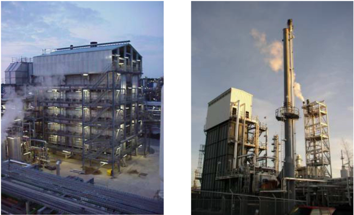
Figure 1.12 : Exemples de Four de reformage à la vapeur.
