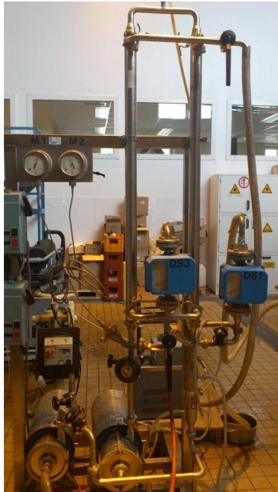
Photo 3: Pilote d'ultrafiltration tangentielle
