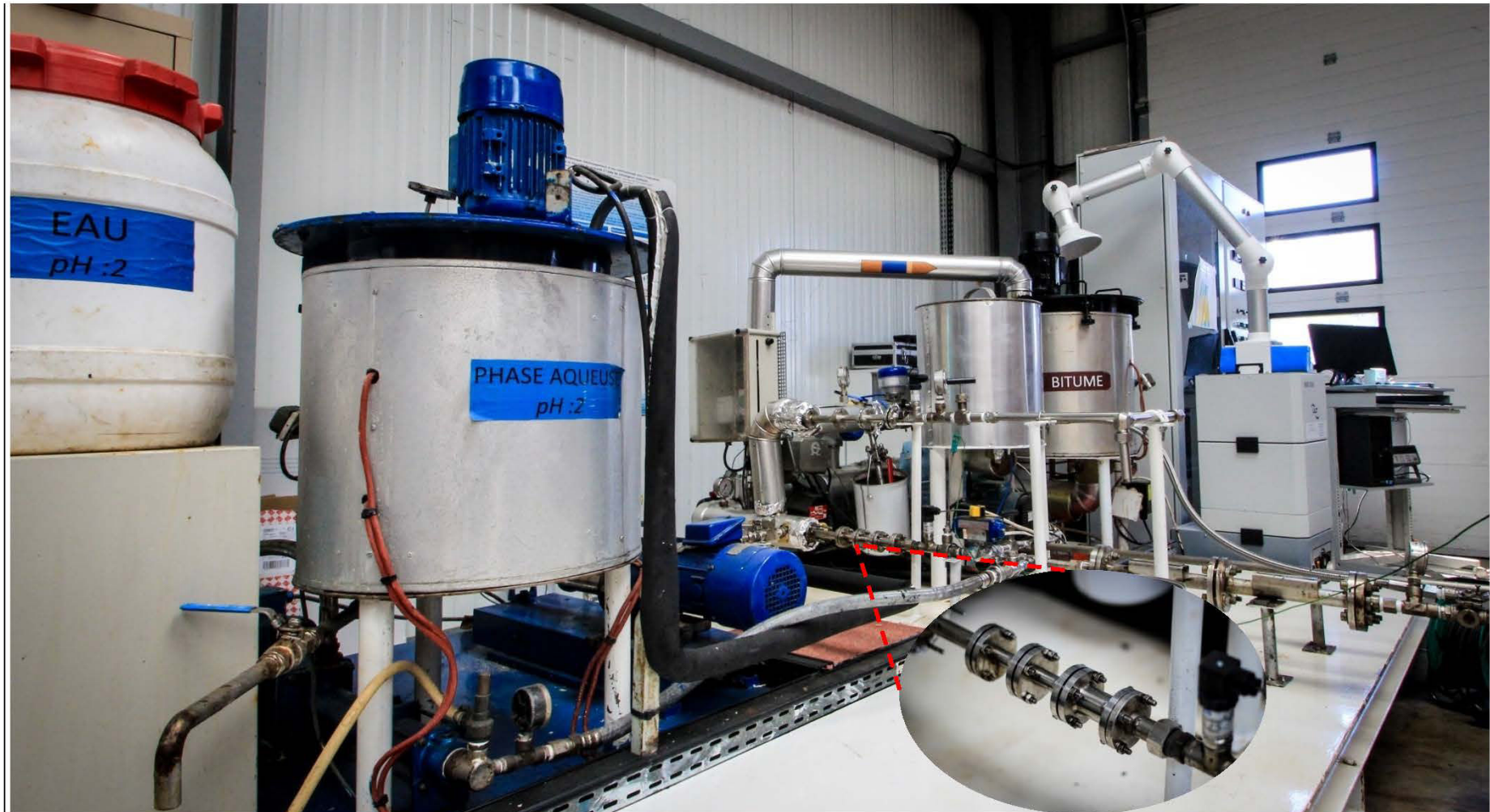
Figure 44. Pilote pour la fabrication d'émulsions de bitume à l'aide de mélangeurs statiques (Photo : V. Darraillan. Centre de Recherche d'Eurovia Mérignac, 2014)
