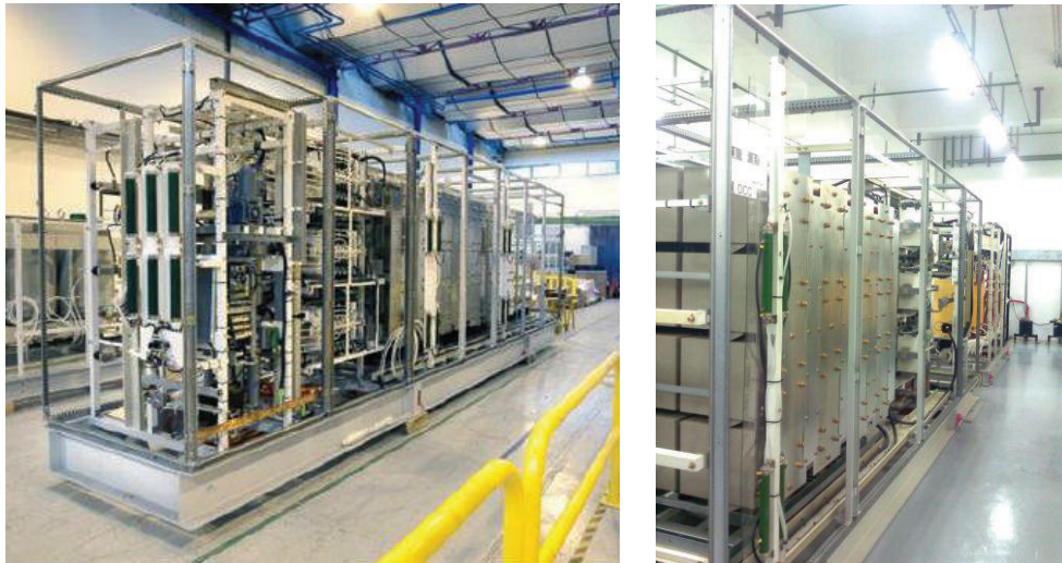
Figure 3 : (gauche et droite) Convertisseur MV7000 NPP 3-niveaux 27MVA
