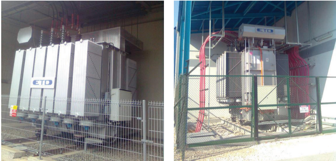
Figure 6 : Transformateurs abaisseurs du DSVC : (gauche) 33kV/2,4kV – S=55MVA ; (droite) 33kV/8kV – S=69MVA
