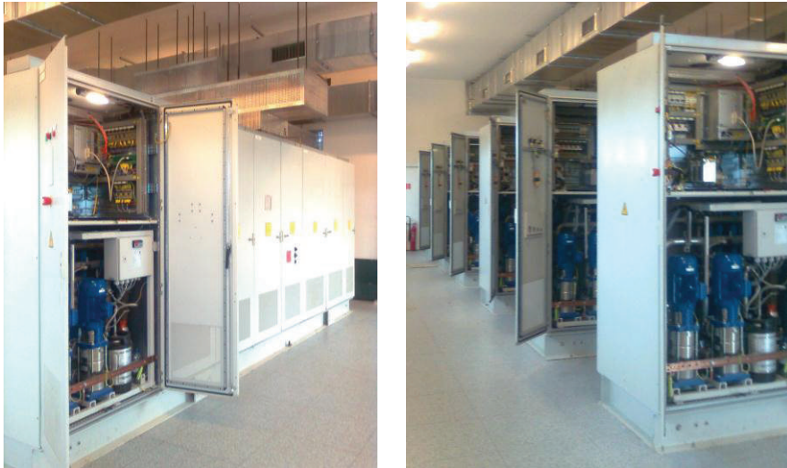
Figure 2 : Convertisseur MV7000 : (gauche) Un convertisseur NPC 3-niveaux 8MVA ; (droite) Rangées de six convertisseurs en parallèle
