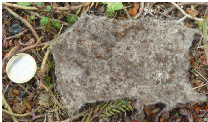
Figure 50 - Présence de particules de substrat en surface et dans le filtre géosynthétique (prélèvement d'avril 2013 - toiture des Vosges)
