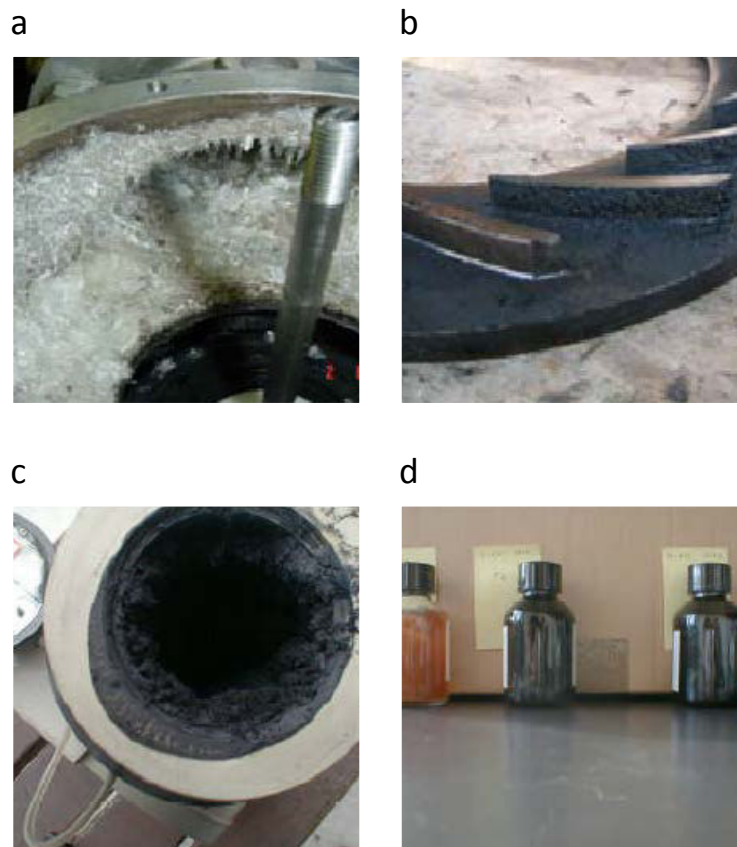
Figure 7 : Problèmes provoqués par les goudrons : (a) - dépôt de naphtalène dans un moteur à gaz (Herdin et al., 2004) ; (b) - dépôt de suies dans le moteur ; (c) - encrassement de la tuyauterie ; (d) - contamination de l'eau de lavage.
