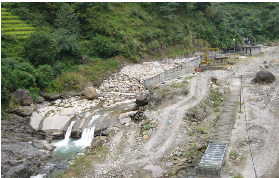
Figure II.10 - Station de captage d'eau au sud de la vallée de la Khudi Khola, à environ 4 km de la confluence avec la Marsyandi
