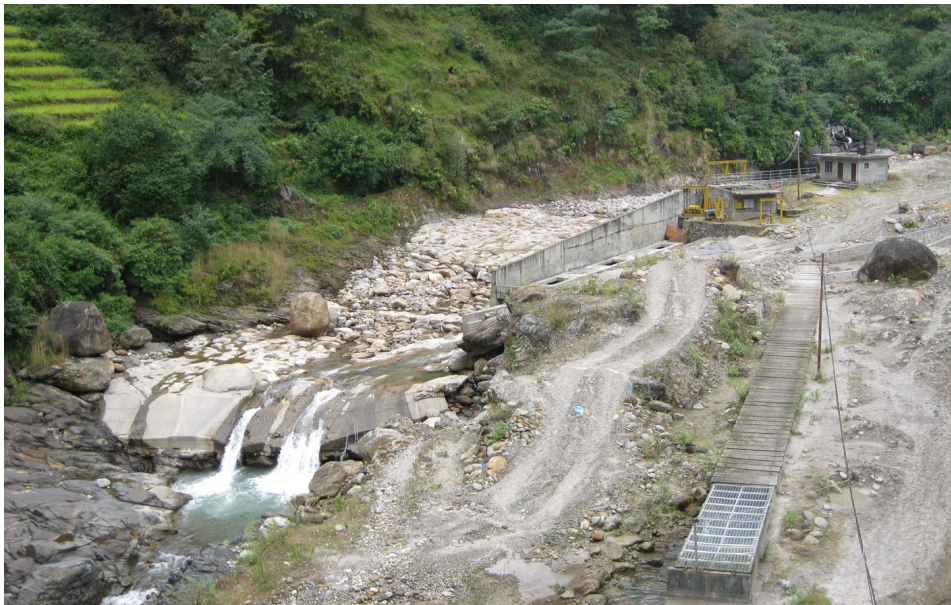
Figure II.10 - Station de captage d'eau au sud de la vallée de la Khudi Khola, à environ 4 km de la confluence avec la Marsyandi
