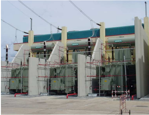
a) Transformateurs monophasés
