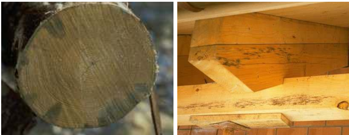
Figure 15 : Photographies des dégradations liées au bleuissement sur bois fraîchement abattus (à gauche), ou en service (à droite) (21)
