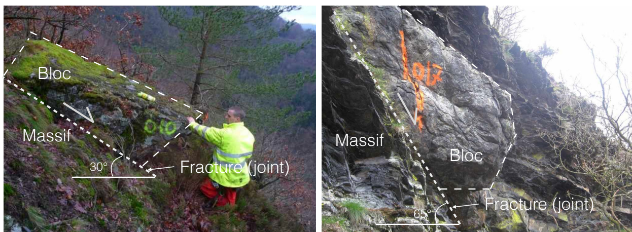
Figure 39. Cas réels de glissements plans avec des pentes inférieures et supérieures à 50^\circ .
