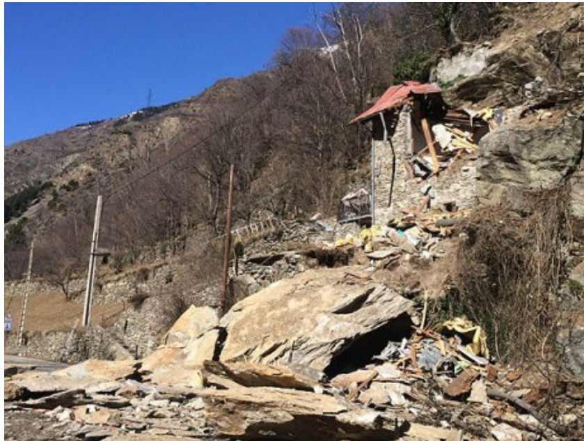
Figure 1. Eboulement de 100 m 3 de roches, causant la destruction d'un chalet, et la mort de deux enfants, le 23 février 2014 (L'Express, 22 Février 2014).
