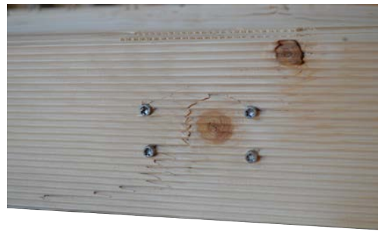
(b) Poutre 5 : rupture à un nœud
