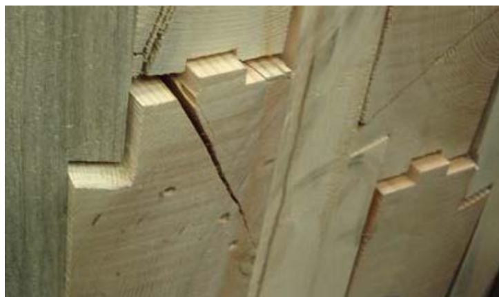
FIGURE 1.11 – Rupture par glissement des pièces
