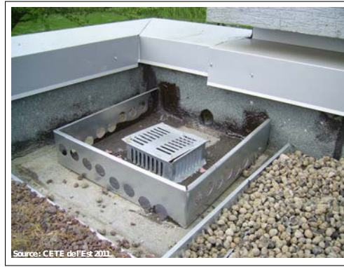
FIGURE 4.14 – Régulation de la hauteur d'eau par système de bouchons.
