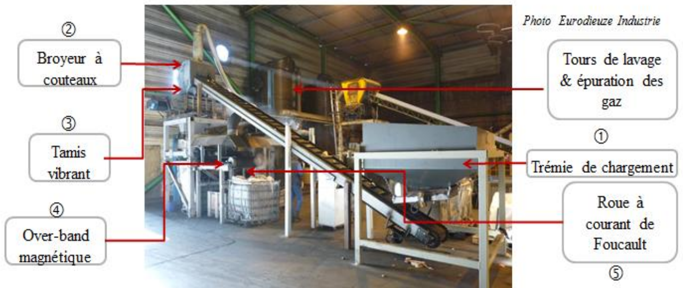
Figure 12 : unité de broyage des piles et accumulateurs à Eurodieuze Industrie
