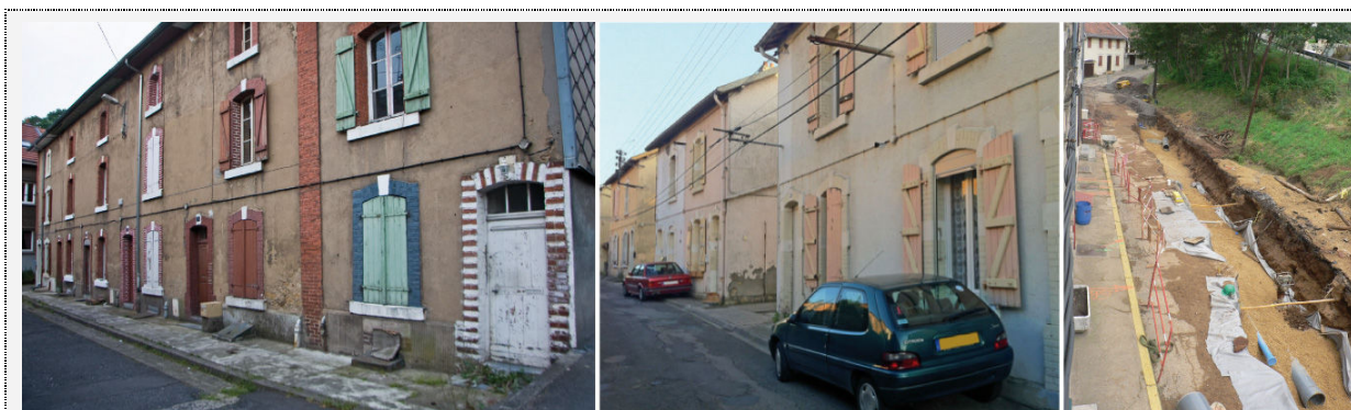
Photos 6, 7 et 8 : La dégradation de certaines cités ouvrières à Villerupt (Del Biondo, 2012, 2007)
