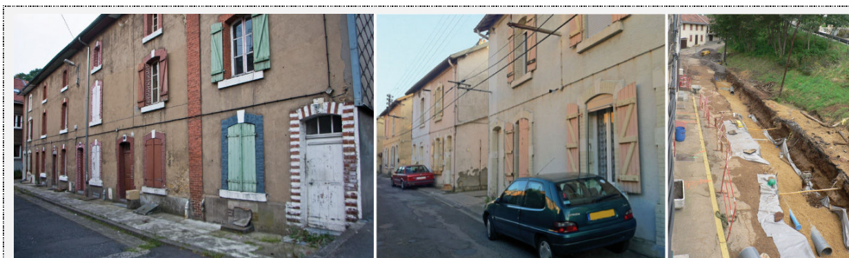
Photos 6, 7 et 8 : La dégradation de certaines cités ouvrières à Villerupt (Del Biondo, 2012, 2007)
