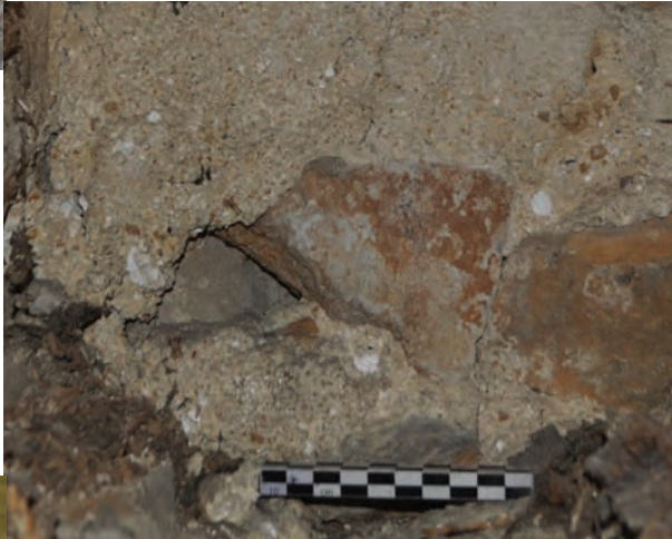
Fondremand - XIV e s. Mortier à l'intérieur d'un empochement de poutre du plancher du 5 e niveau. Abattage du chêne, automne-hiver 1381-1382
