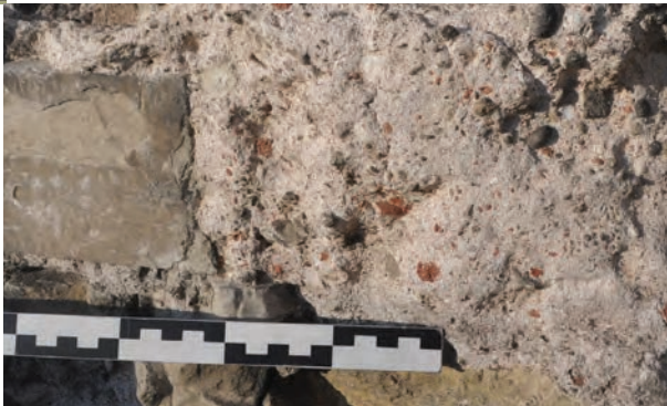
Bainville - XV e s. Ébrasement d'une fenêtre du 2 e niveau Liant riche en inclusions de cailloux et terre cuite pilée
