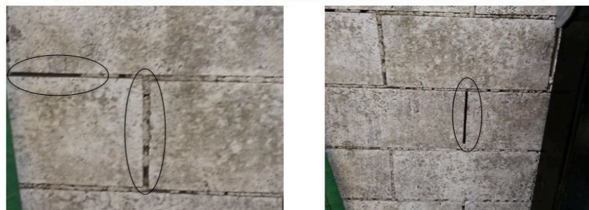
Figure 108 : Défaut de construction : quelques joints ne sont pas remplis complètement de mortier
