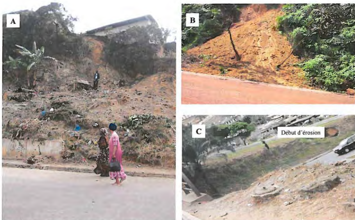
Figure IV.7.2 : Eboulement au sommet d'un talus de la base d'une maison route PK6-Nzeng-Ayong Libreville (A), éboulement route Nationale au village Gniali dans la Nyanga (B) et début d'érosion, pente voie express PK6 sens Plein ciel-PK6 Libreville (C)
