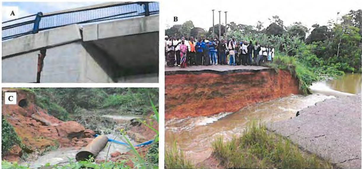
Figure IV.7.1 : Pont du cimetière de Lalala (A), affaissement de la dalle de bitume au village Meyang (B) et la rupture des canalisations au quartier Bangoss (C)
