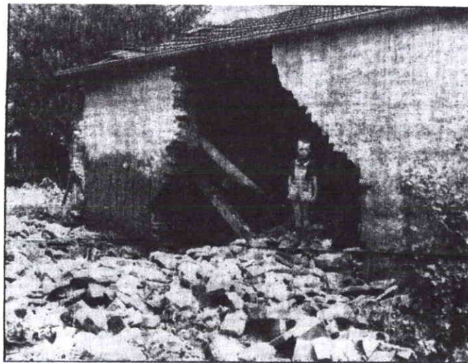
Les flots, tranchant la ferme de M. Georges DROUOT, à Gircourt-lès-Viéville, où ils atteignent une hauteur de près de deux mètres, ont emporté une partie du mur arrière pour se frayer passage. (Lire notre information en « Réson ».)
