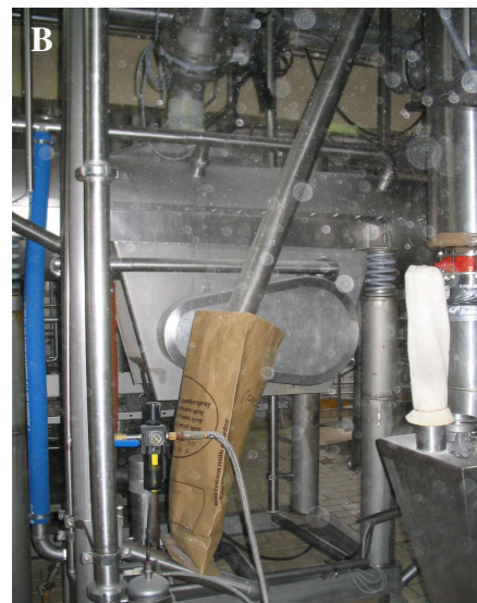
Figure 31 : Récupération des poudres granulées (A) en sortie du lit fluidisé et des poudres non granulées (B) directement en sortie des cyclones
