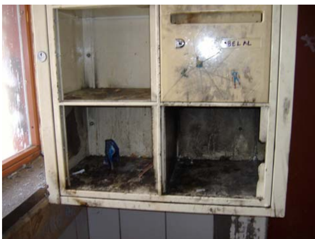
Vue des éléments vandalisés de boîte aux lettres de cette même entrée, utilisés comme cendrier.
